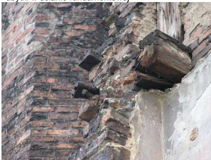
Fot. 3 – końcówka odciętego ściągu stalowego, kikut odciętej belki stropowej
