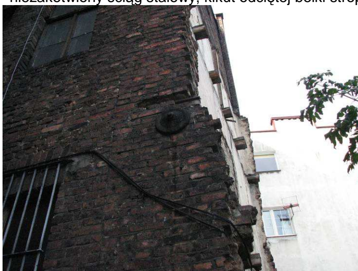
Fot. 6 – niezakotwiony ściąg stalowy, nierówne i wystające pozostałości ściany po rozbiórce
