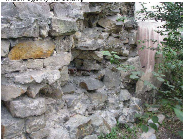
Fot. 2 – ubytki w ścianie fundamentowej
