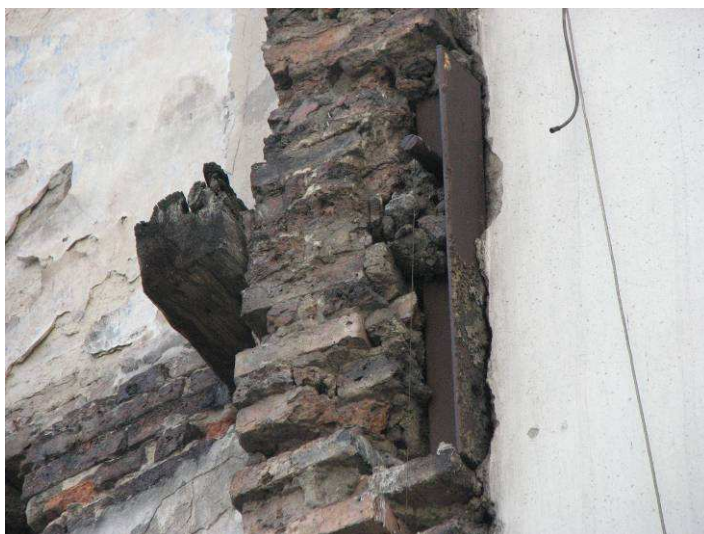
Fot. 4 – zakończenie ściany stalowej, kikut odciętej belki stropowej, pozostałości ściany
