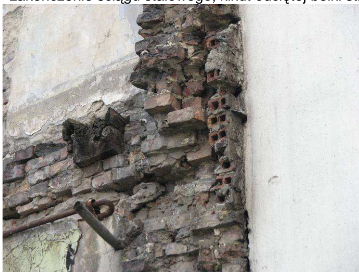
Fot. 5 – niezakotwiony ściąg stalowy, kikut odciętej belki stropowej, pozostałości ściany
